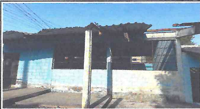
Foto: 1 parte de enfrente del aula con lamina y ventanas destruidas
