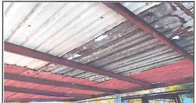
Foto: 4 Lamina del corredor con daños cosiderables
