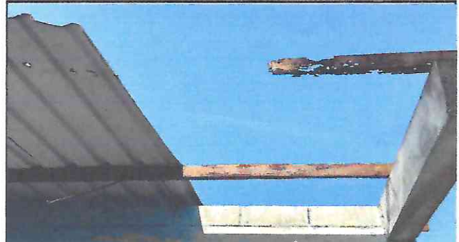
Foto: 2 costaneras y laminas destruidas por los vientos
