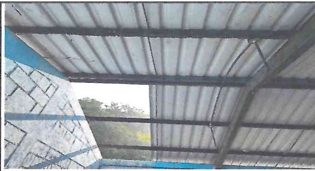
Foto: 3 Lamina interior del aula con muchos daños
